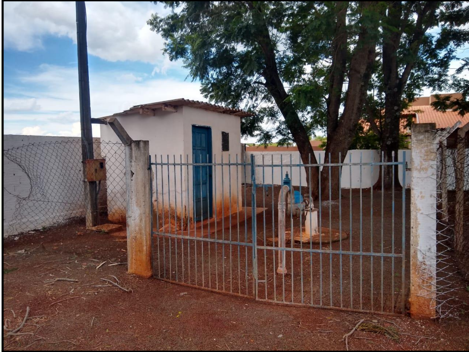
Figura 10 – Estação de Captação do Campo
