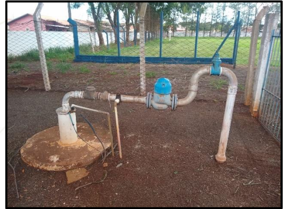
Estação de Captação Campo
