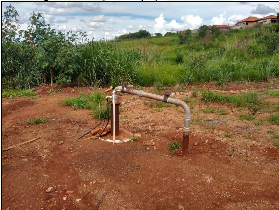
Figura 11 – Estação de Captação Centro de Eventos
