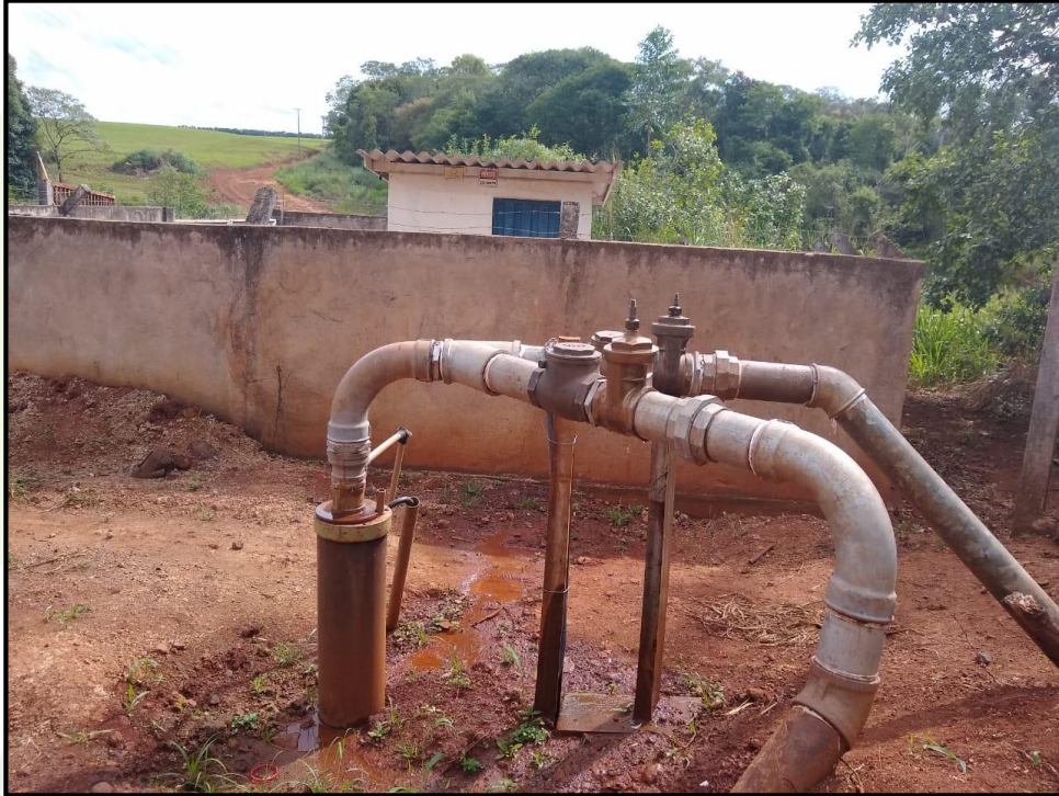
Figura 14 – Estação de Captação Vila Rural 2
